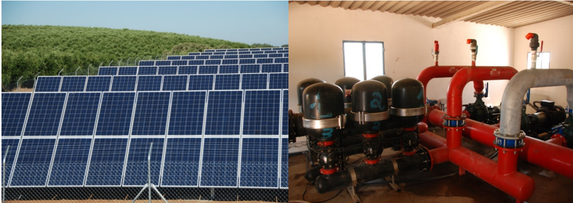
Fig. 9. Generador fotovoltaico (izquierda) y bombas (derecha) en el sistema híbrido fotovoltaico-diésel de Alter do Chão. Hay que notar que el generador fotovoltaico tiene el aspecto de un generador estático, pero en realidad es un seguidor sobre un eje horizontal. Cuanto a las bombas, se puede identificar por el color de la tubería la bomba añadida en el momento de la instalación del sistema fotovoltaico.
